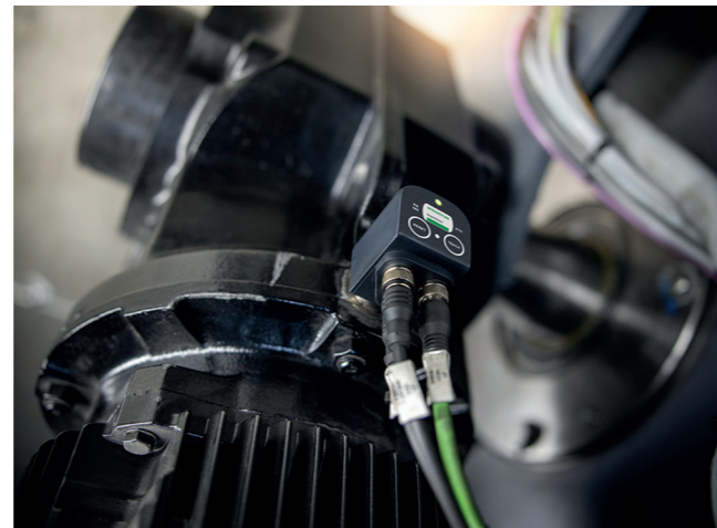
Solution de maintenance conditionnelle Centre logistique : SmartCheck surveille les moteurs des transstockeurs
