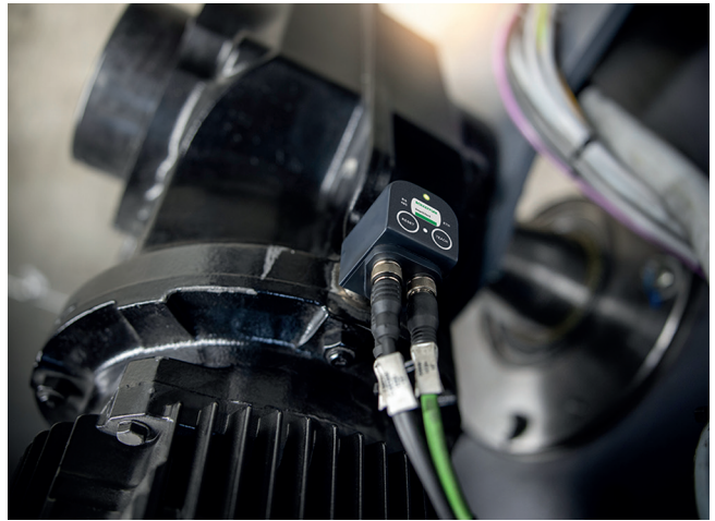
Condition-Monitoring-Lösung Logistikzentrum: SmartCheck überwacht Motoren von Regalbediengeräten
