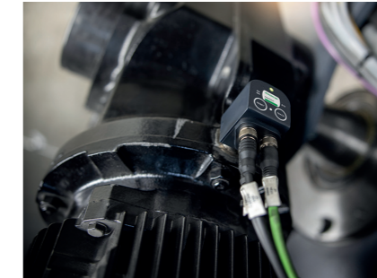
Logistikzentrum: SmartCheck überwacht Motoren von Regalbediengeräten
