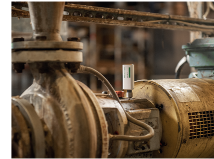
Papeterie : OPTIME CM s'avère performant pour la surveillance des moteurs
