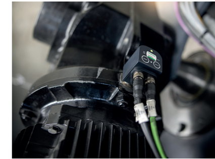
Centre logistique : SmartCheck surveille les moteurs des systèmes de stockage automatisés
