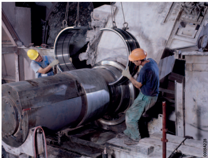
图 7 大型剖分式调心滚子轴承的安装
