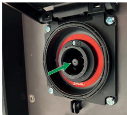
41 Puša za induktorski priključek na generatorju
